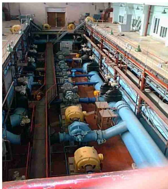
Joonis 2. Veepuhastusjaama masinasaal
