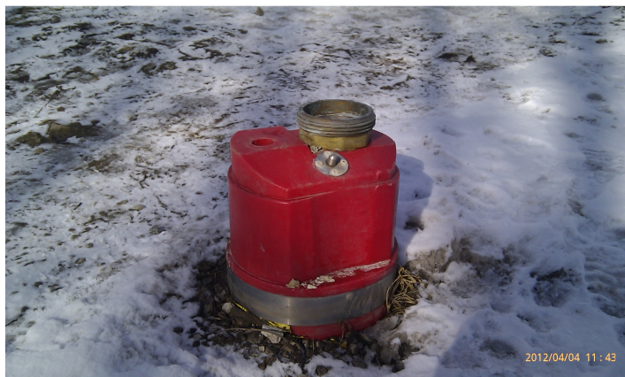
Joonis 12. Vandalismi ohvriks langenud hüdrant.
