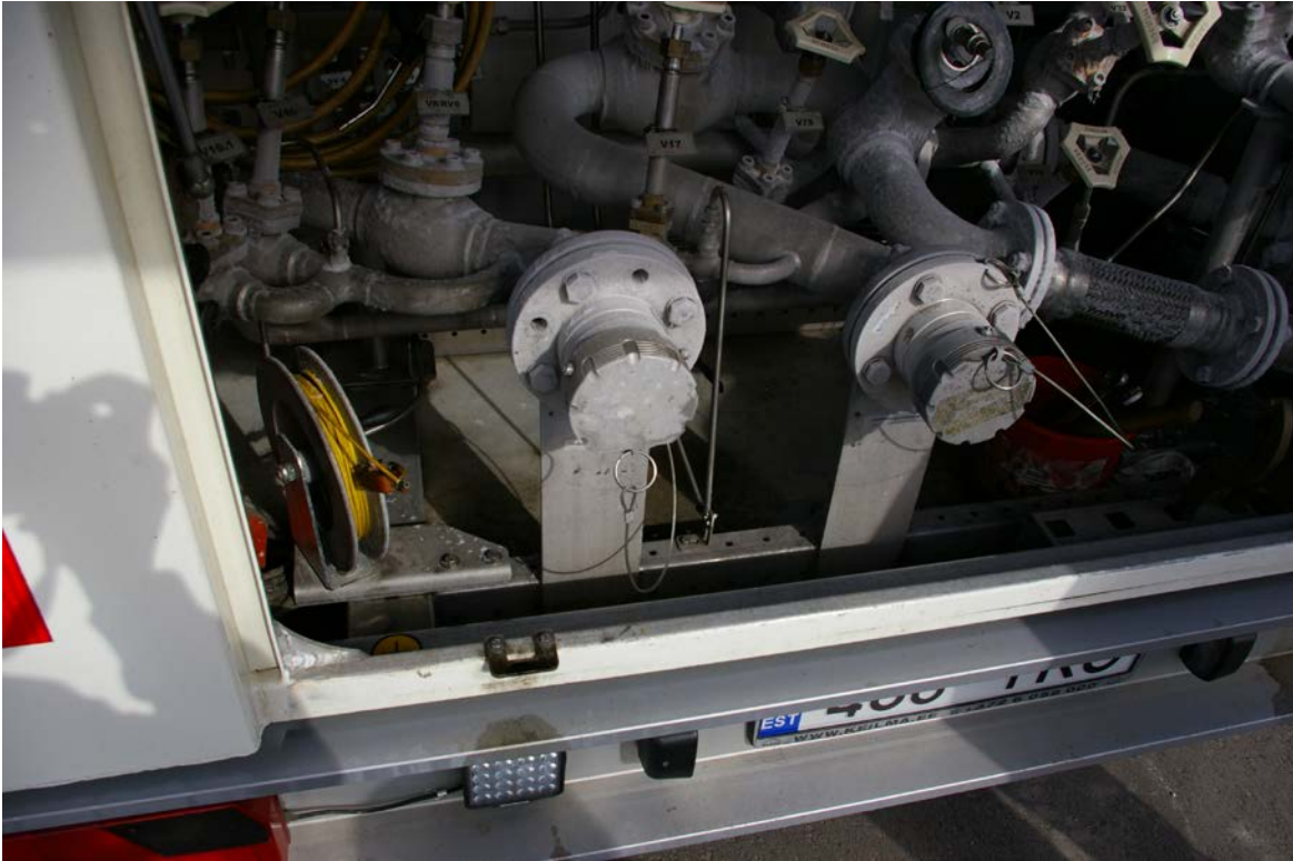
Joonis 13. AS Eesti Gaasi tsisterni pumbasüsteemi väljund (vasakpoolne) ja sisend (parempoolne). (autori pilt)
